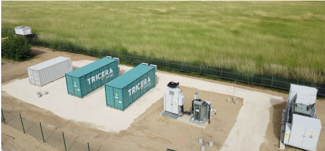
Bild: Symbolbild eines TRICERA Batteriespeichers, wie er für die Stadtwerke Karlsruhe gebaut wird
